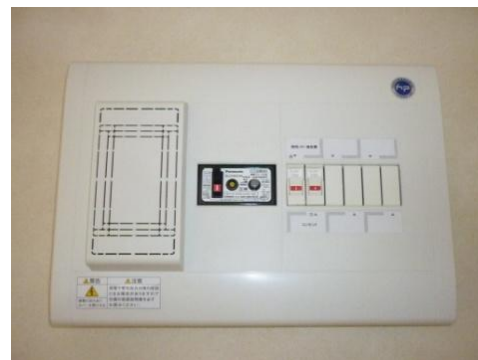
居室分電盤（ブレーカー）
