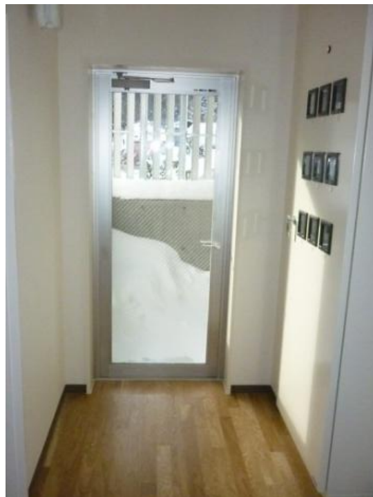
5. 非常口 (Bユニット側)
