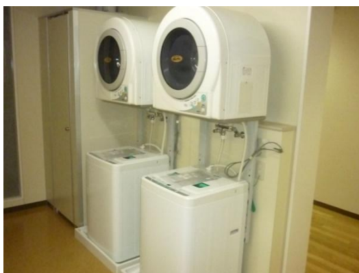
16. 洗濯機 17. 衣類乾燥機
